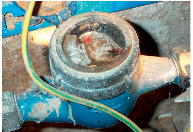
Defekte Wasserzähler waren auch 2012 Hauptgrund für Versorgungsunterbrechungen. Quelle: OTWA
